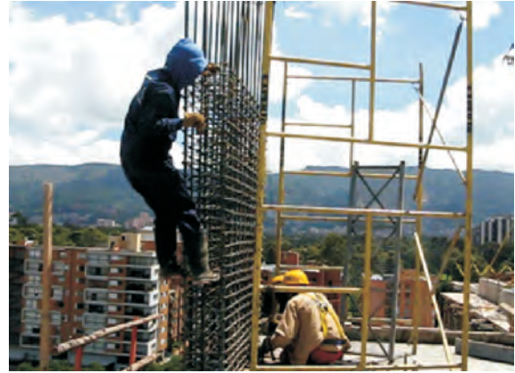
Fotografía 6. Falta de utilización de la línea de vida.
