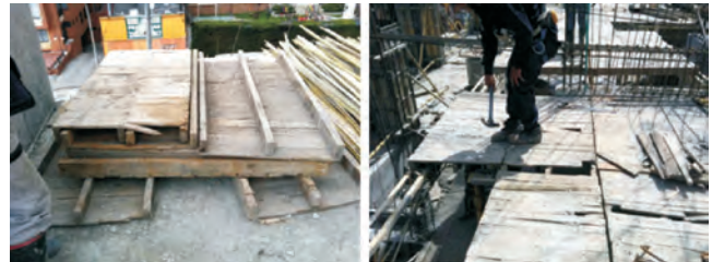
Fotografía 7. Mal estado de las camillas.
