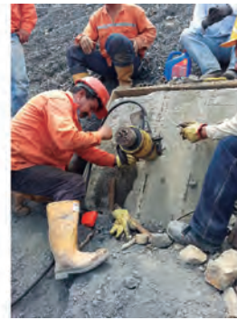
Fotografía 6. Tensionamiento de la prueba de falla.
