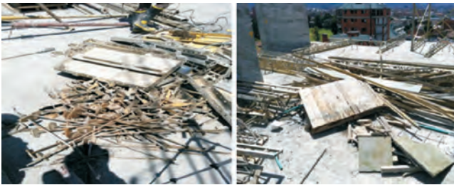
Fotografía 4. Inadecuada disposición del material de obra, que interrumpe la circulación.
