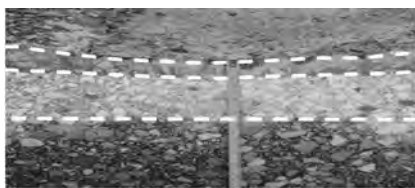
Fotografía 3. Ahuellamiento no estructural (5).
