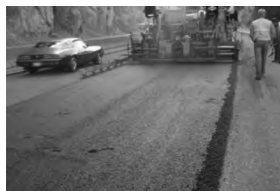
Figura 30. Segregación tras el eje de la pavimentadora (ref. 11).
