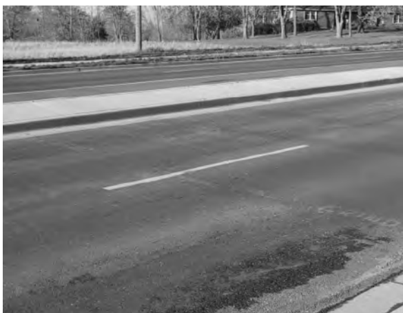
Figura 1. Carpeta de concreto asfáltico segregada.
