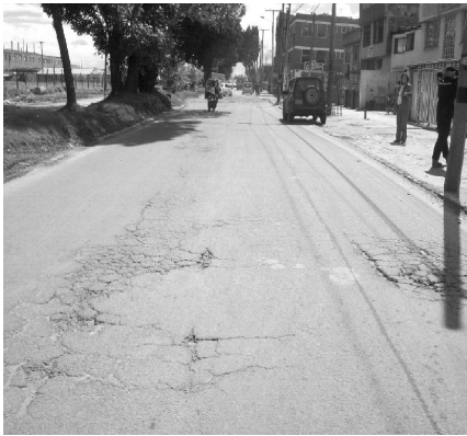
Figura 2. Estado superficial tramo AM80100.
