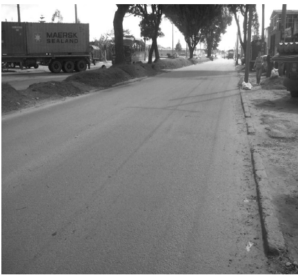
Figura 3. Estado superficial tramo PMSBS.
