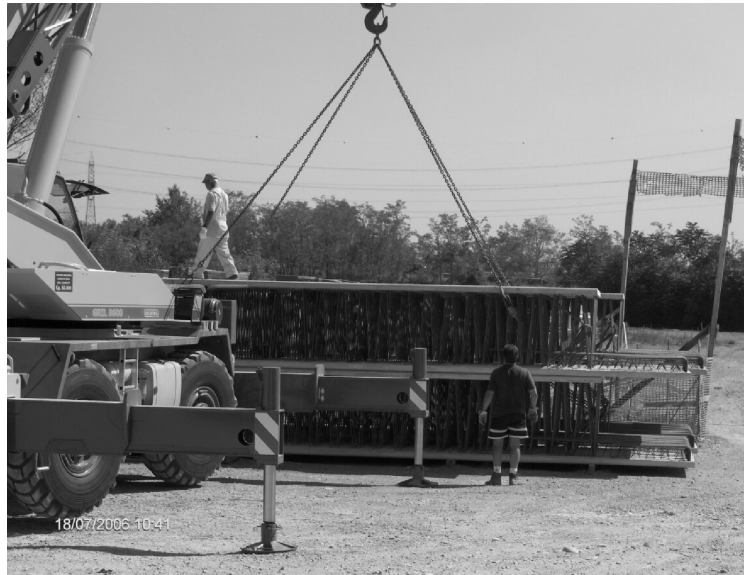
Figura 6. Almacenamiento de la bilastra.
