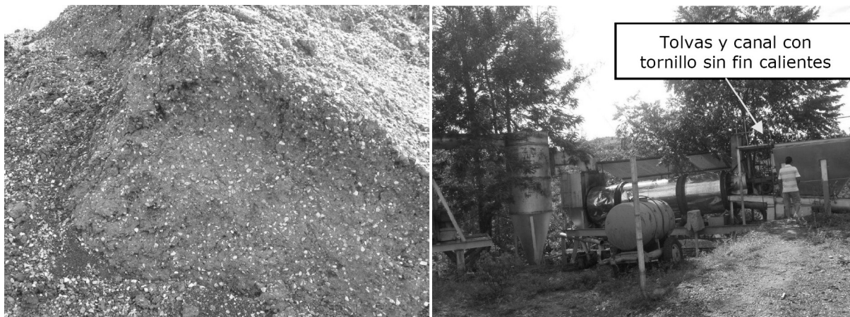
Fotografías 7.1 MOAN premezclado y la Planta para mezcla en caliente.
