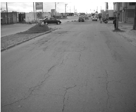
Figura 5. Estado superficial tramo PMSBR.
