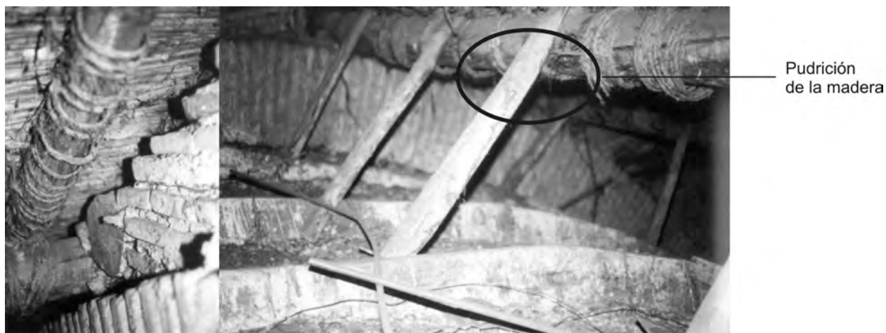
Figura 7. a) deterioro de los amarres; b) pudrición de las vigas.
