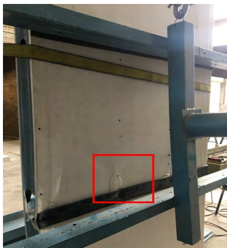
Fotografía 5. Pandeo local panel doble.
