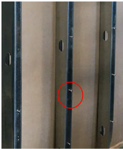
Fotografía 2. Falla de la conexión revestimiento - montante.
