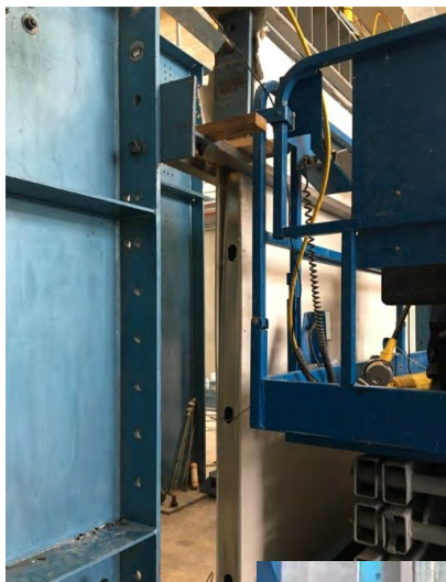
Fotografía 8. fractura del revestimiento-separación del marco metálico-revestimiento.
